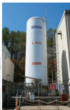
岩手工場 LNG燃料転換
