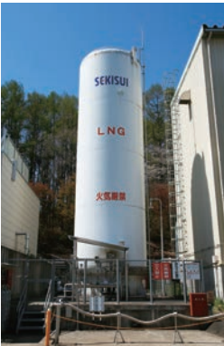
岩手工場 LNG燃料転換
