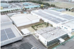
つくば工場 太陽光発電システム
